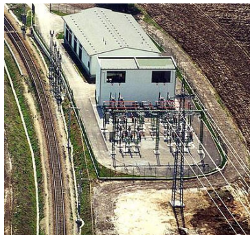
Napájecí stanice jednofázové střídavé trakce.
